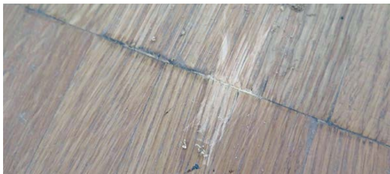
Entfernen der Verschmutzung durch Abschaben, darunter Holz ohne Verfärbung.
